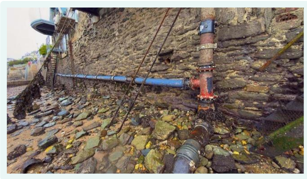
Fowey foreshore sewer
